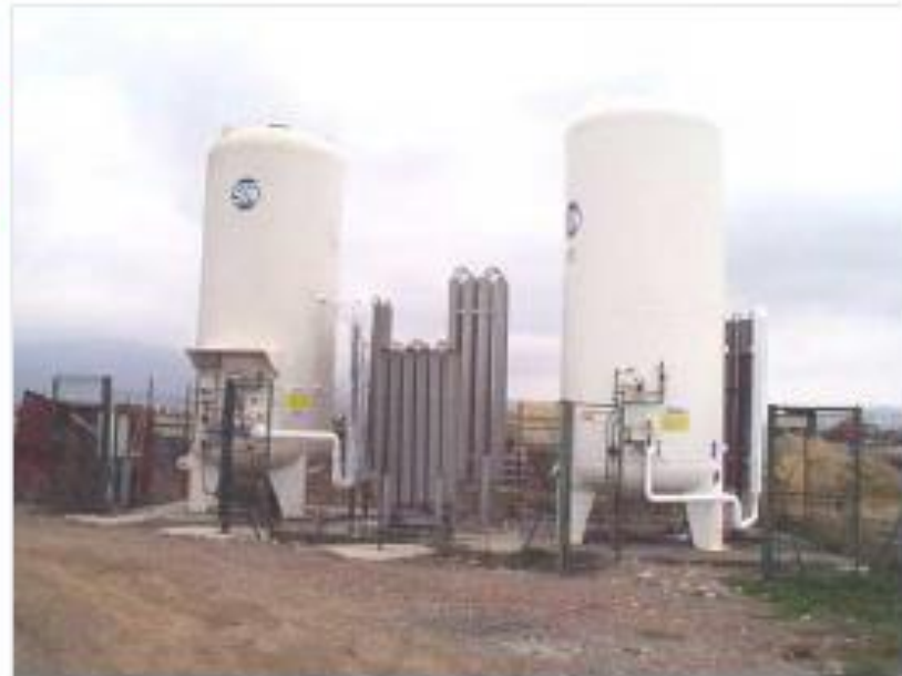
Serbatoi di ossigeno liquido
